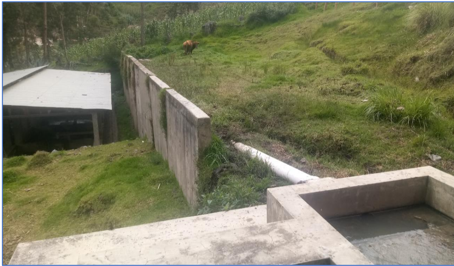
Figura 36. Tubería de ingreso al tanque Imhoff
