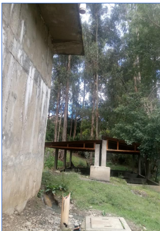
Figura 67. Vista de Tubería de salida al filtro biológico
