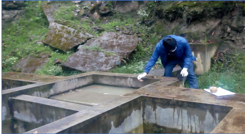
Figura 50. Vista de la estructura expuesta a erosión.
