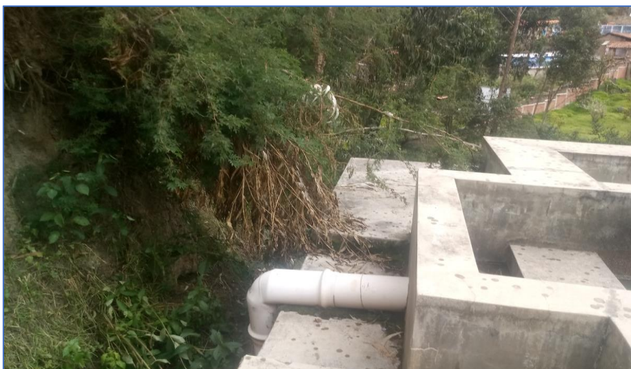
Figura 35. Vista de Tubería de salida al filtro biológico
