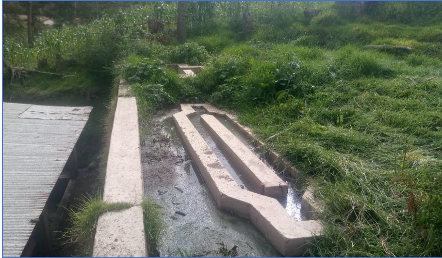
Figura 26. Vista general del desarenador y la cámara de rejas
