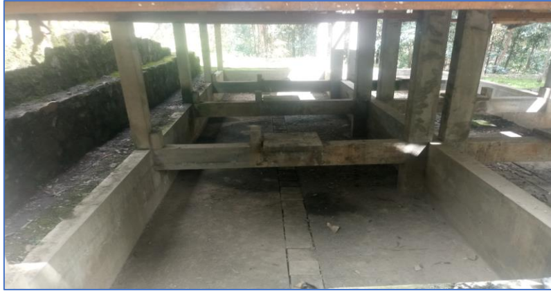
Figura 56. Vista de instalaciones sanitarias en el lecho de secado de la PTAR N° 01.
