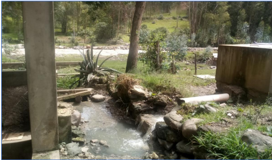
Figura 71. Vista de instalaciones sanitarias en el lecho de secado
