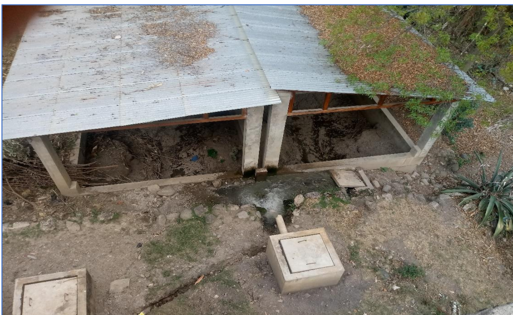
Figura 4. Lecho de Secado de la PTAR N° 03
