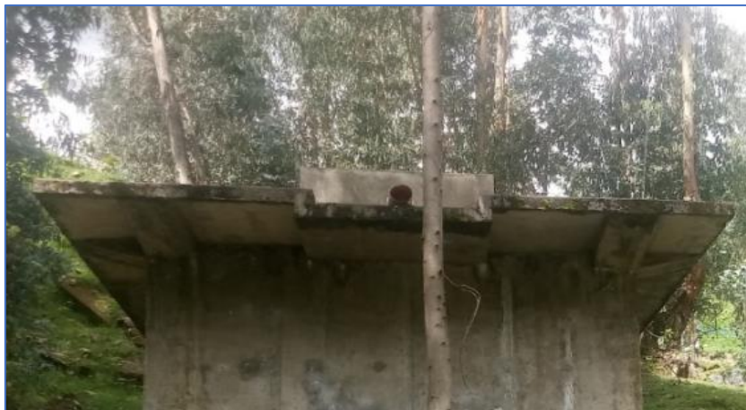
Figura 51. Vista de Tubería de salida al filtro biológico
