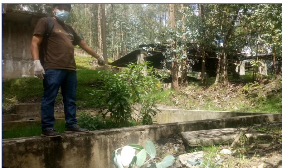
Figura 57. Vista del Filtro Biológico de la PTAR N° 02
