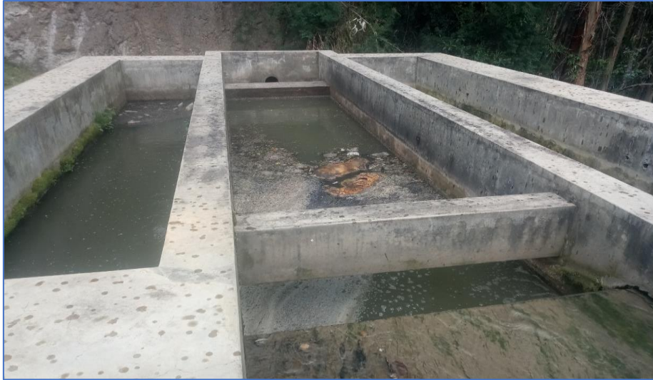
Figura 34. Vista de la estructura expuesta a erosión.
