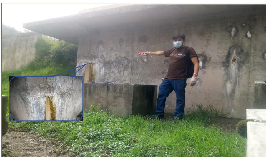
Figura 31. Vista de la Eflorescencia en el tanque Imhoff
