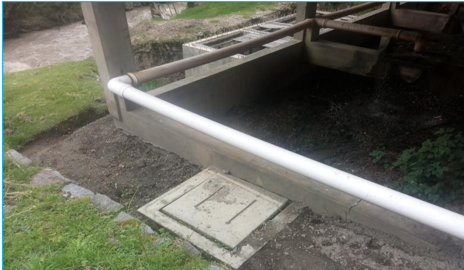
Figura 41. Vista de instalaciones sanitarias en el lecho de secado de la PTAR N° 01.
