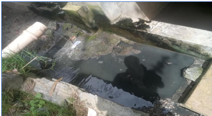
Figura 52. Tubería de ingreso al lecho de secado
