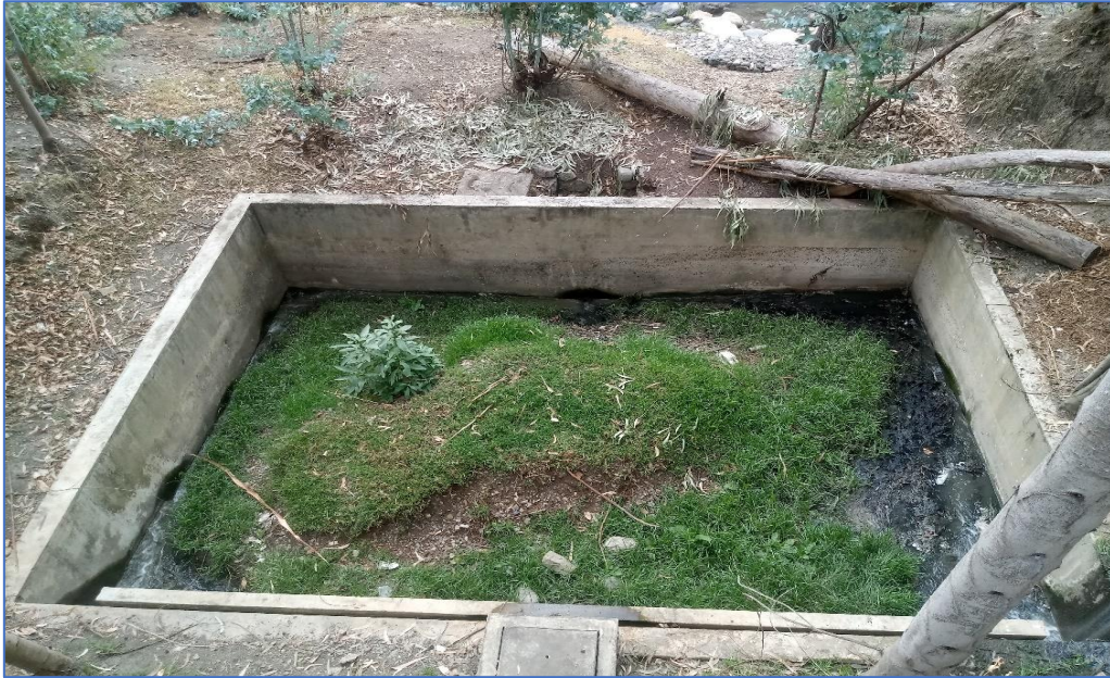
Figura 3. Filtro Biológico de la PTAR N° 02
