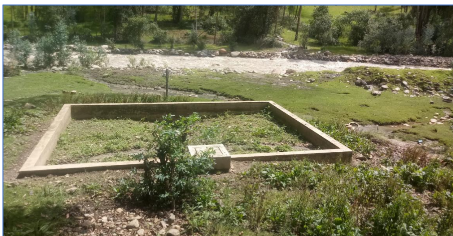
Figura 72. Vista del Filtro Biológico de la PTAR N° 03
