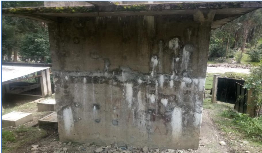
Figura 62. Vista de la Eflorescencia en el tanque Imhoff
