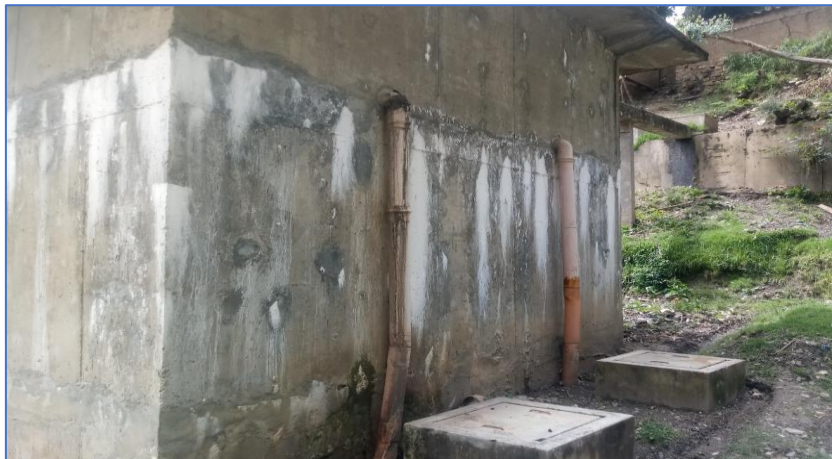
Figura 66. Tubería de salida al Lecho de Secado
