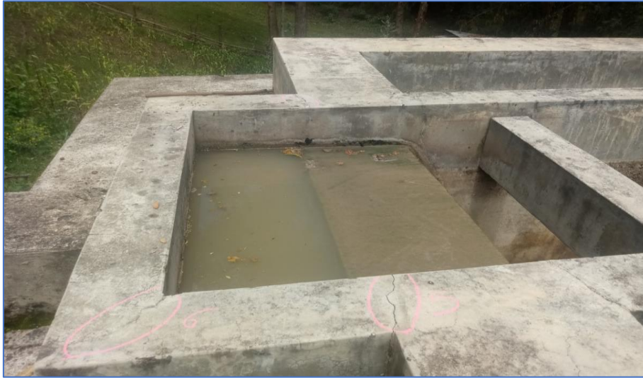
Figura 65. Vista de la estructura expuesta a erosión.
