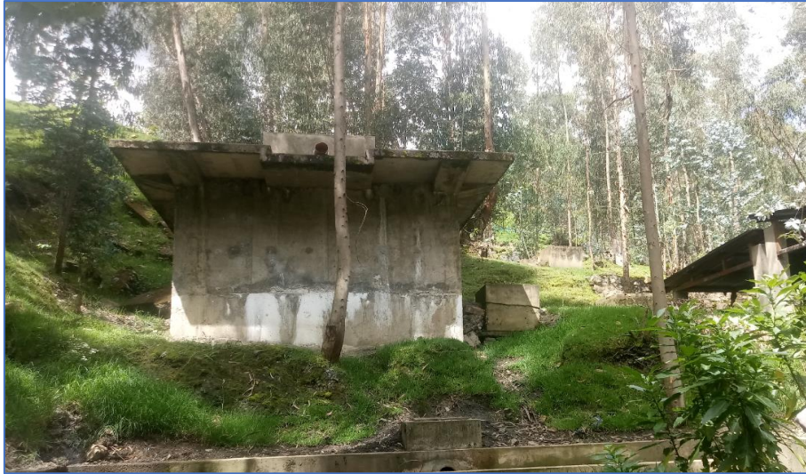
Figura 47. Vista de la Efluentes en el tanque Imhoff
