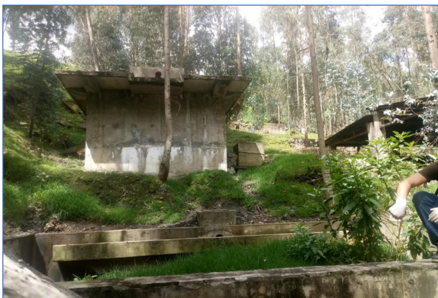
Figura 43. Vista panorámica de la PTAR N° 02
