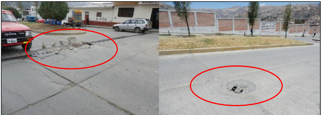
Fotografía N° G.02: Algunas alteraciones en las vías que dificultan el tránsito vehicular, Av. Antonio Raymondi, altura del Ministerio del Trabajo
