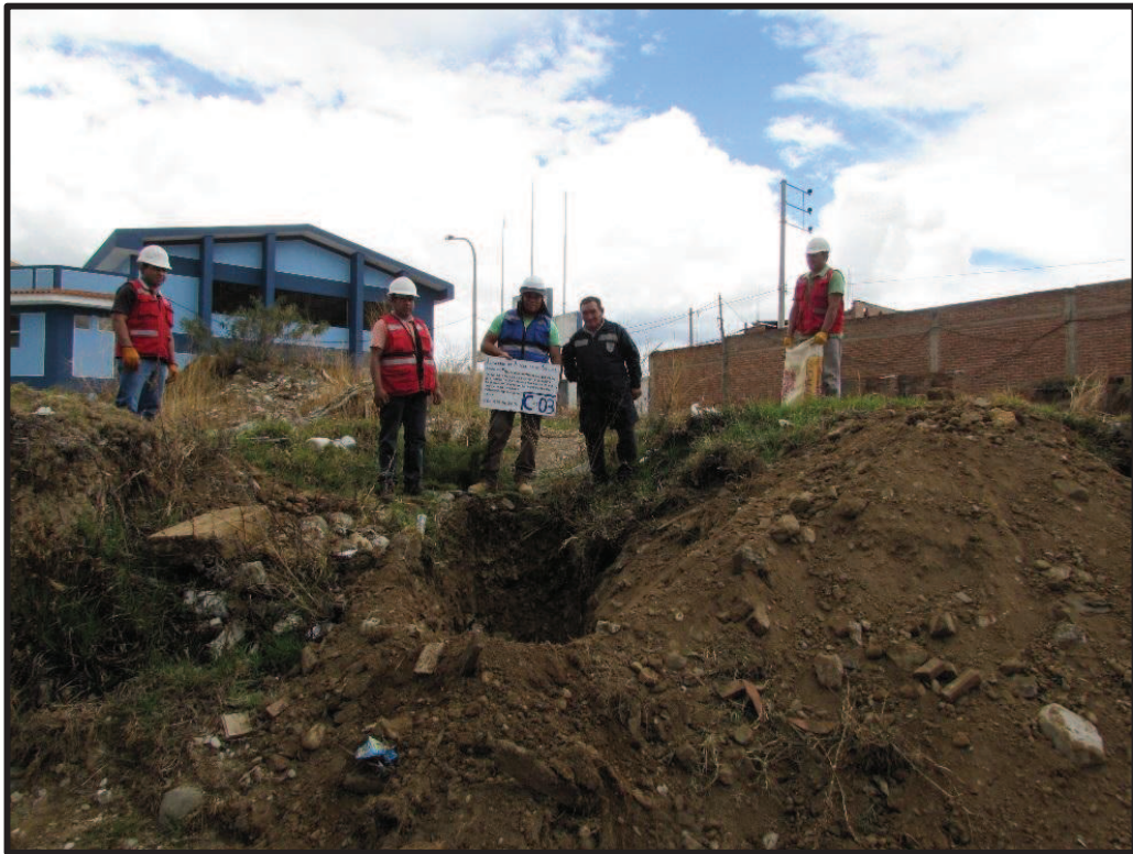
Figura 32: Se muestra la excavación de la calicata N° 03 para las aulas comunes. (Fuente: Elaboración propia)
