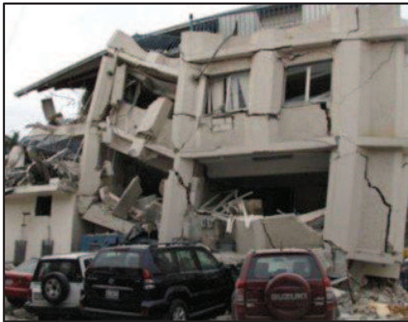
Figura 12: Daño observado en las edificaciones luego del sismo del 2007 en la ciudad de Pisco.
