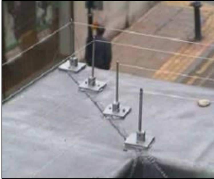
Figura 19: Sistema de cables anti palomas Avistrand.
