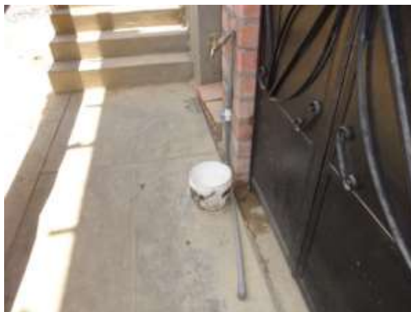
Figura N°19: Tubería instalada en vereda por falta de plan de contingencia
