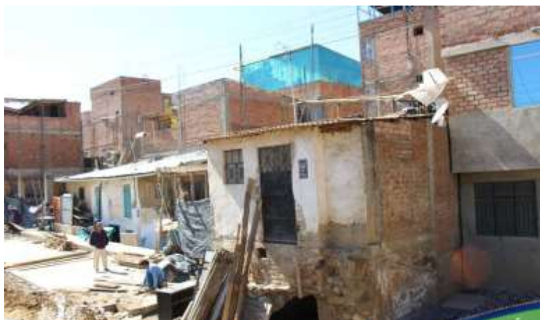
Figura N°29: Vivienda que tuvo que ser demolida por invadir vía pública
