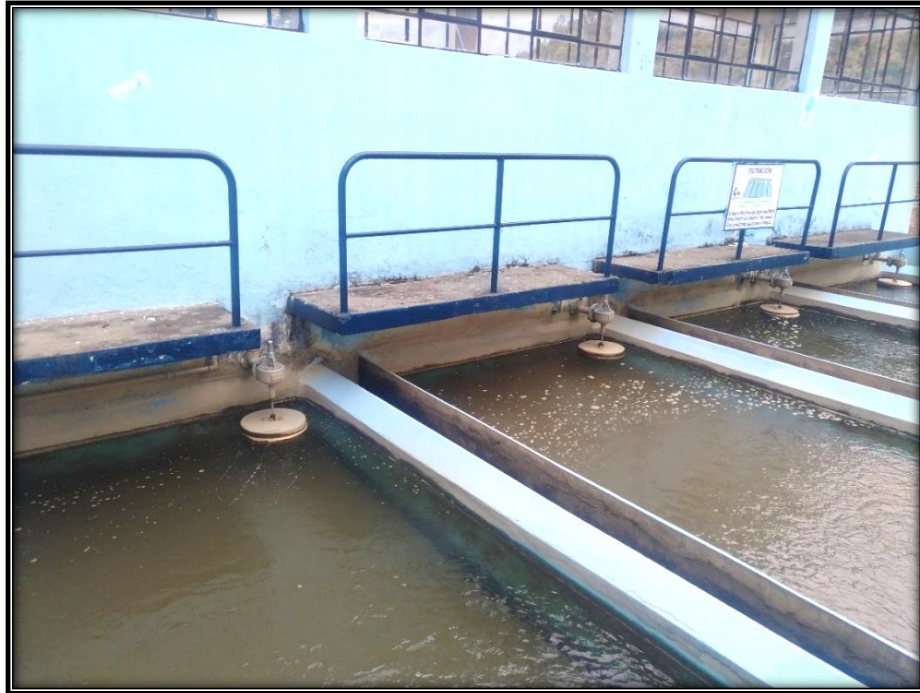
Fotografía 18: Elementos donde se observa mantenimiento, pero se evidencia desgaste
