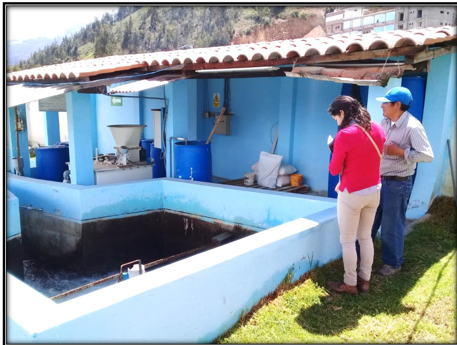
Fotografía 15: Se evidencia desgaste en la estructura
