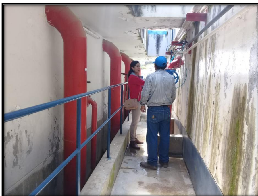
Fotografía 21: Se observa filtraciones y falta de mantenimiento
