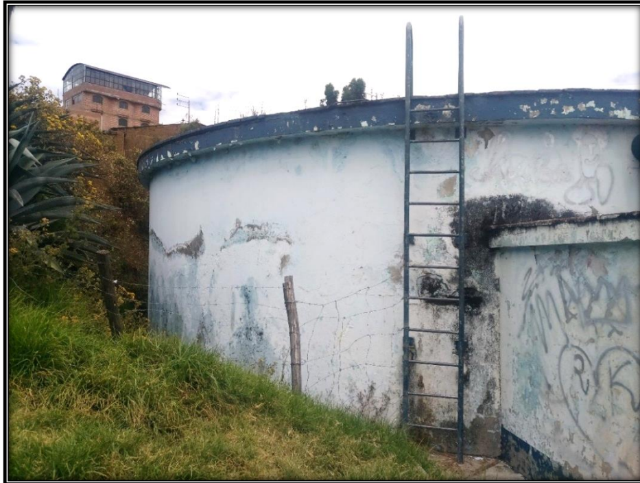
Fotografía 32: Se observa que se encuentra en mal estado, construido hace más de 40 años ( v=250 \text{ m}^3 ).
