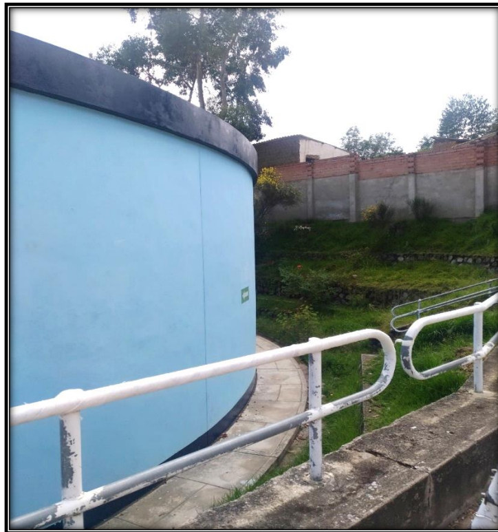
Fotografía 38: Con estructuras de protección y mantenimiento preventivo
