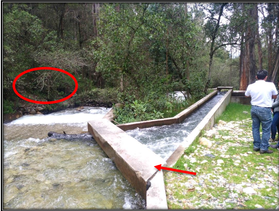
Fotografía 03: Se encuentra con peligros de deslizamiento e inundaciones
