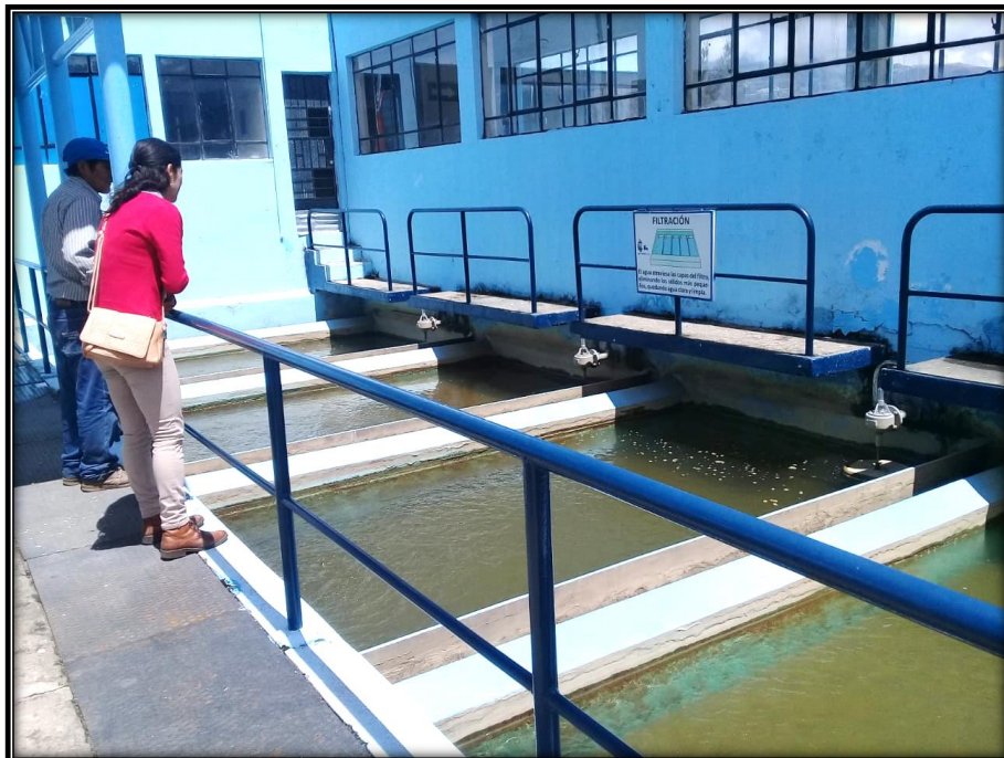
Fotografía 19: Reciben mantenimiento de limpieza de los componentes que un mantenimiento preventivo de la estructura.
