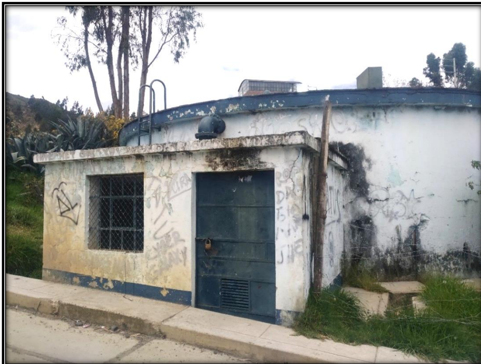
Fotografía 33: Falta de mantenimiento, con rajaduras visibles y desgaste
