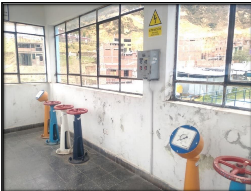
Fotografía 20: Se evidencia desgaste de las estructuras
