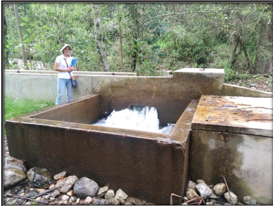
Fotografía 04: Condiciones en estado regular
