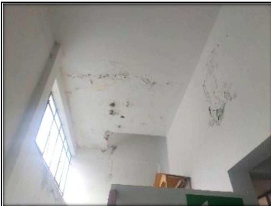
Fotografía 22: Se observan filtraciones en el techo y paredes
