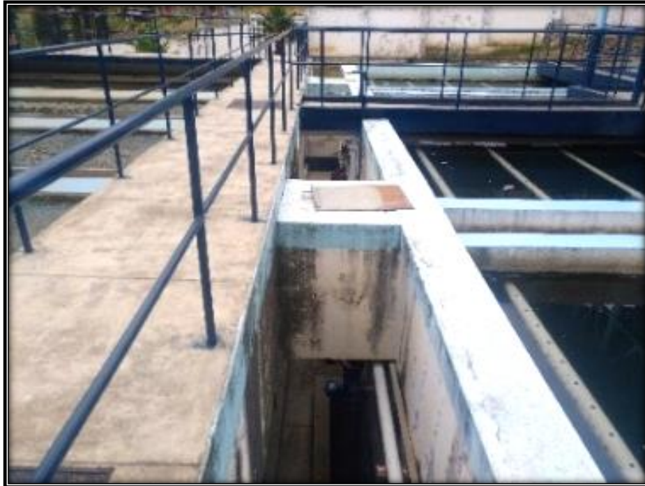
Fotografía 28: Se observa desgaste y paredes perjudicadas por las filtraciones de agua.
