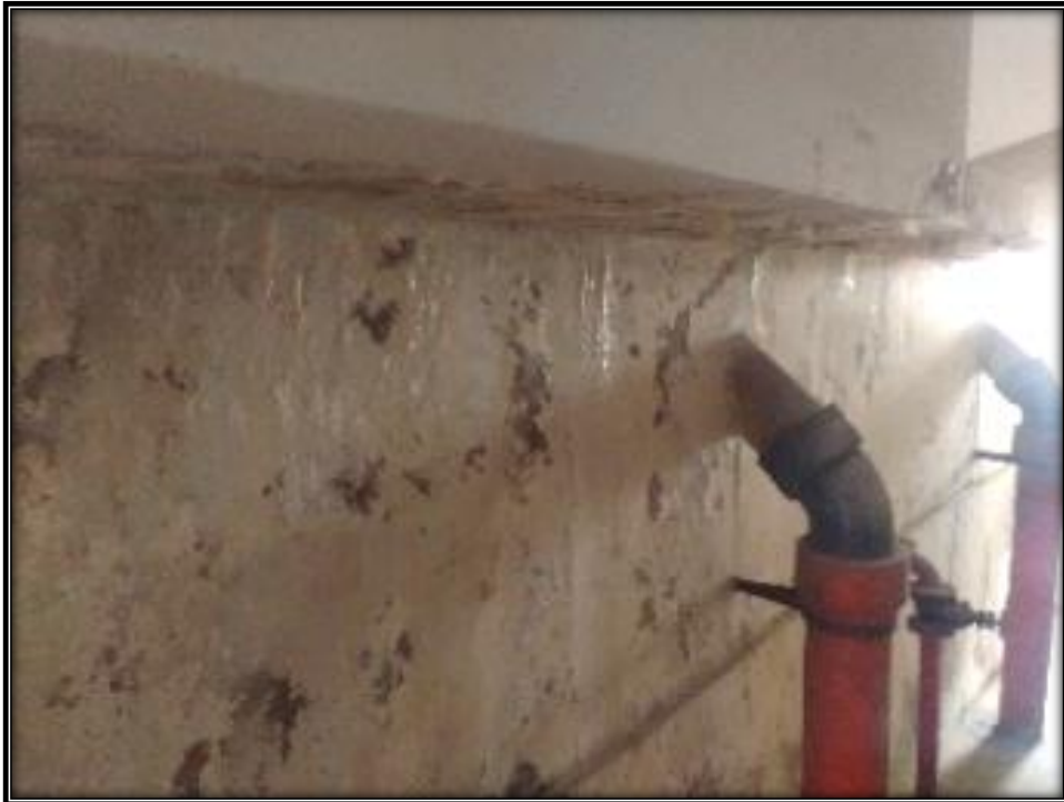
Fotografía 24: Hay paredes donde se presentan más filtraciones y se observan malas condiciones para la estructura.
