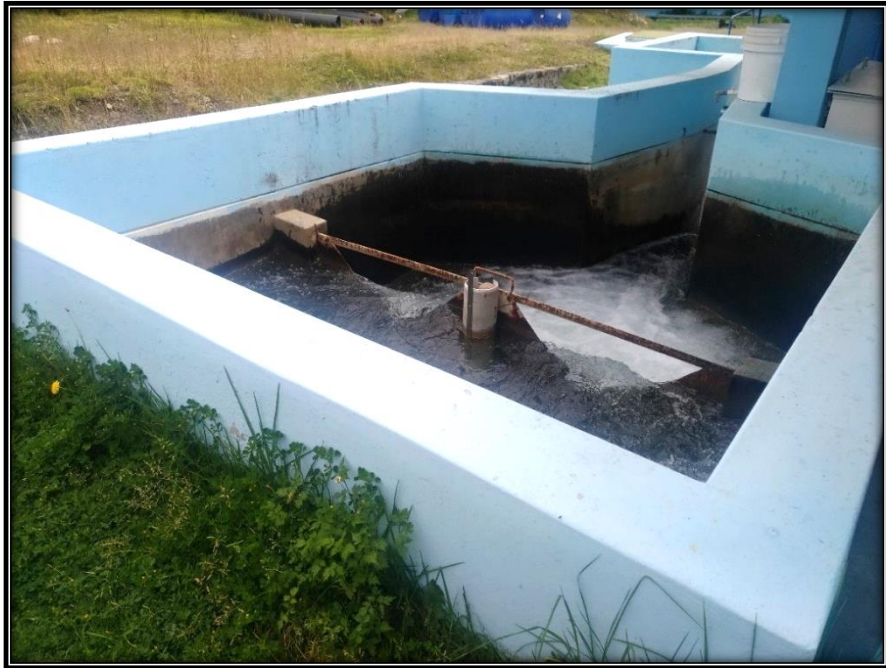
Fotografía 13 y 14: Mezcla rápida en construida hace más de 40 años
