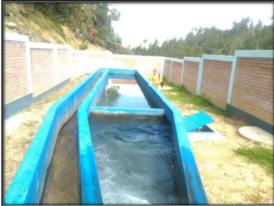
Fotografía 05: Desarenador Bellavista, construido en el año 2017, de 120l/s
