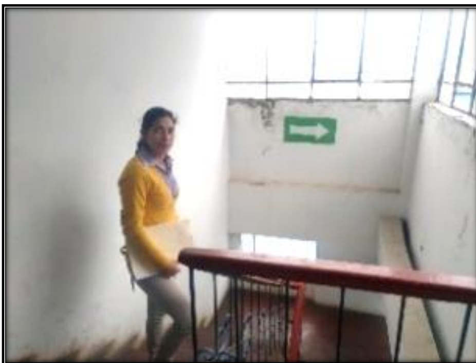
Fotografía 23: Se evidencia también algunas rajaduras
