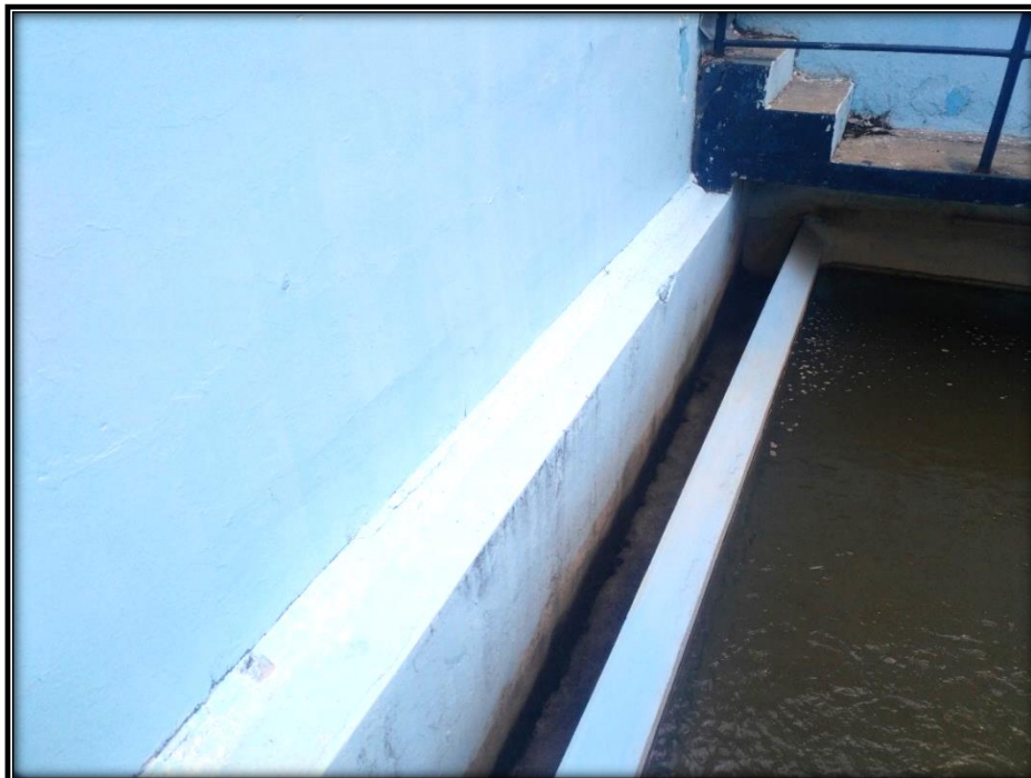
Fotografía 17: Con presencia de rajaduras en las juntas del piso pared
