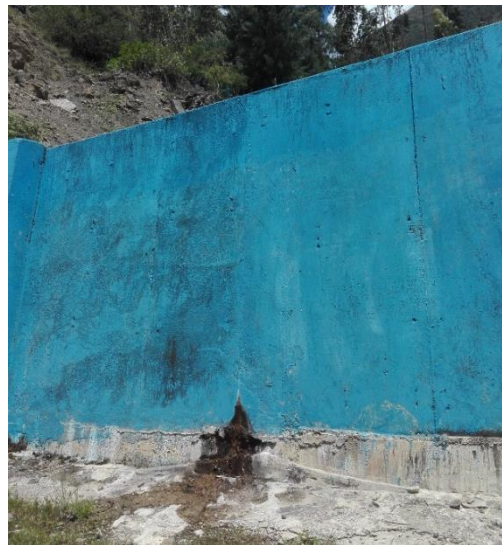
Figura 5. Se Visualiza la Filtracion en la Junta de Dilatación de la Figura Anterior
