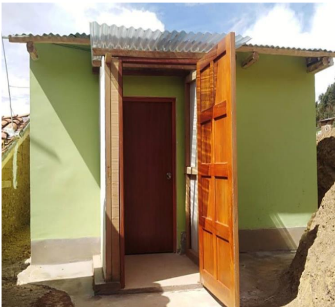
Figura 21. Sistema de aislamiento en puerta (Antepuerta), techado con policarbonato ondulado.
