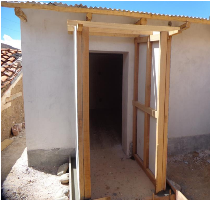
Figura 19. Aislamiento en puerta (Antepuerta), vereda para que soporte estructural cubierta exteriormente con fibrocemento.
