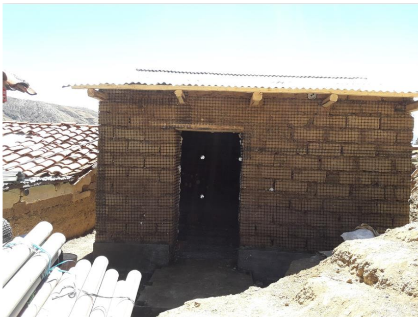
Figura 13. Mejoramiento de muro con geomalla biaxial con el apoyo de alcayatas y rafia.
