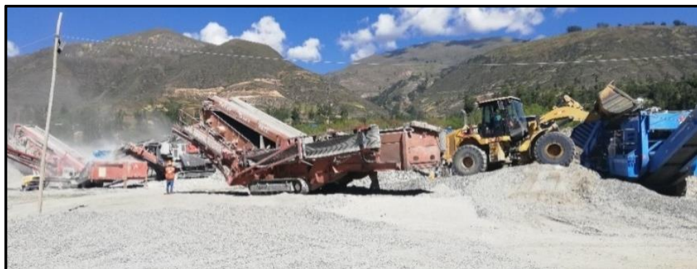
Planta chancadora de agregados para MAC
