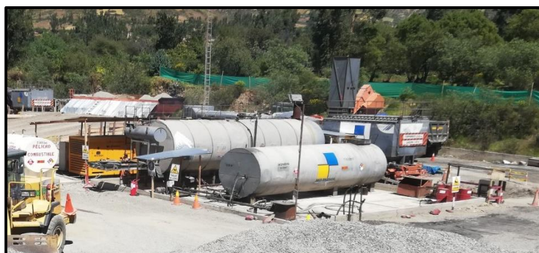
Planta de calentamiento de asfalto para MAC
