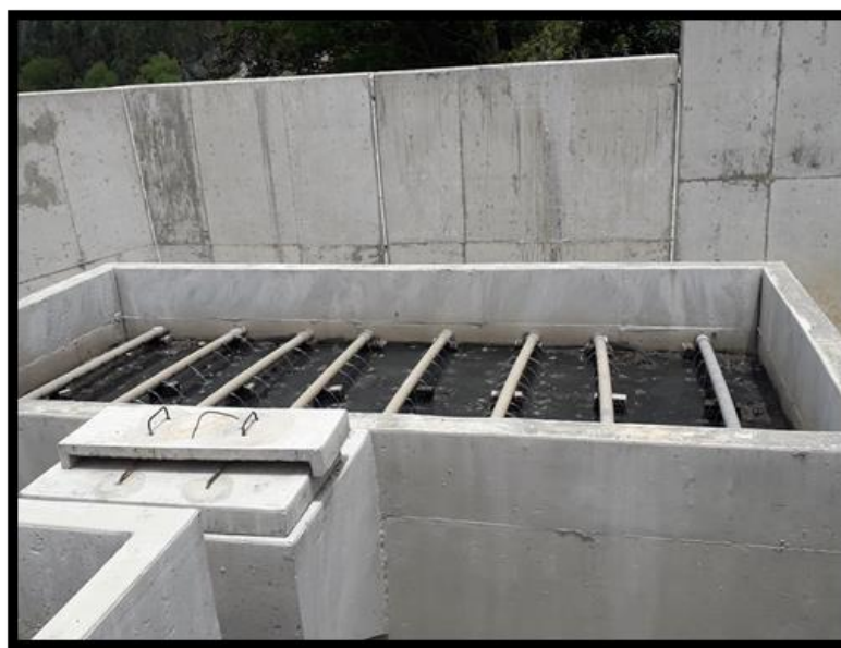
Fotografía 3 PLANTA DE TRATAMIENTO DE AGUAS RESIDUALES CARHUAZ-CARHUAZ-ANCASH
