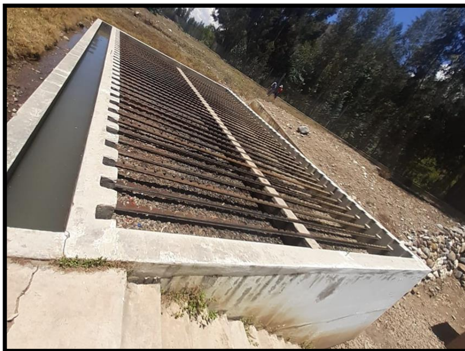
Fotografía 2 PLANTA DE TRATAMIENTO DE AGUAS RESIDUALES JANGAS-HUARAZ-ANCASH
