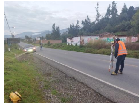
Foto 55: Mediciones en el otro sentido de la vía en la recolección de datos por el método de nivel y mira.
