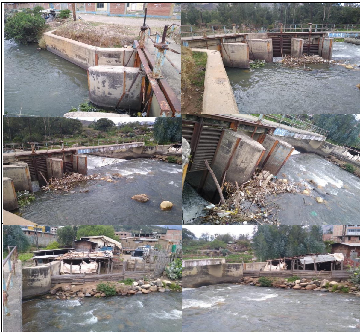
Figura 2 Deterioro de la bocatoma Allpa Rumi en el río Marcará.
