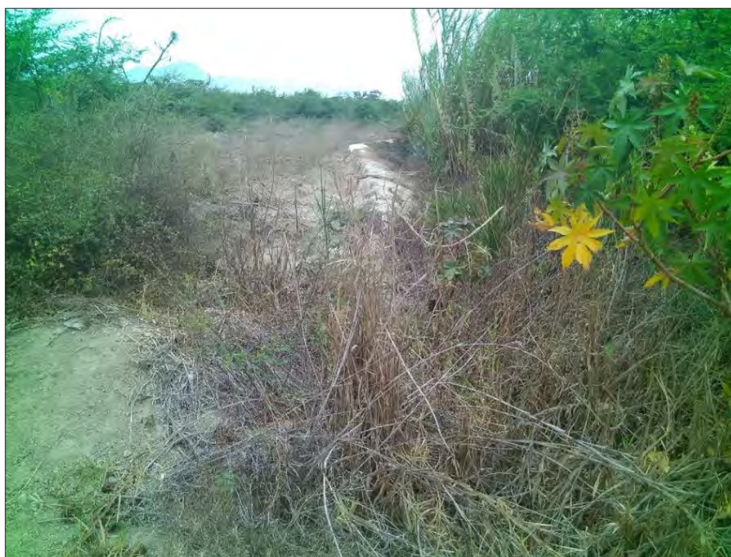
Se muestra recorrido canal Tabón Bajo, destruido después del desborde del Río Casma.
