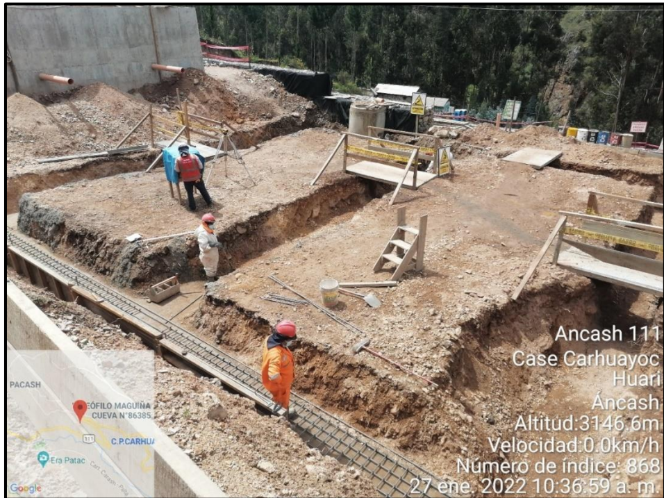
Fotografía 13: Instalación de acero en la cimentación de muros del lecho de secado
