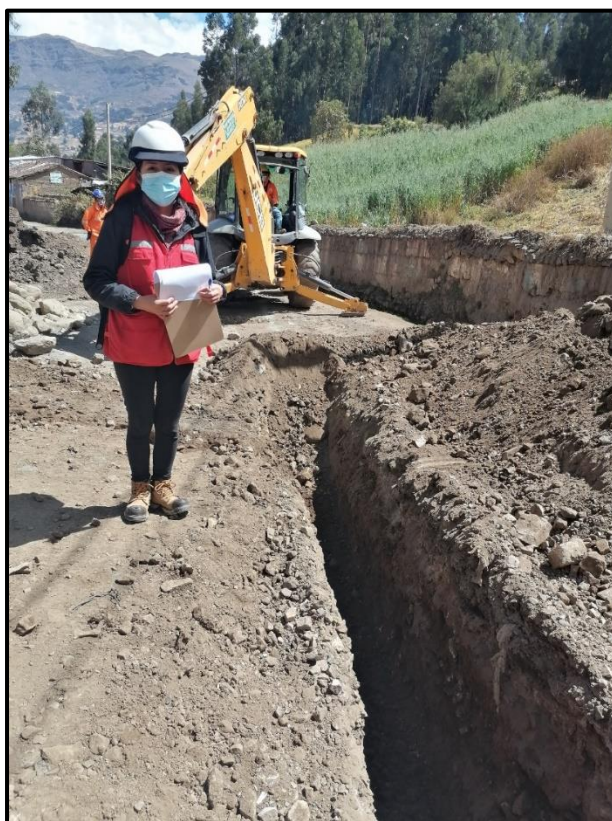
Fotografía 04: Red colector del sector desvío Mayampampa – Grifo
