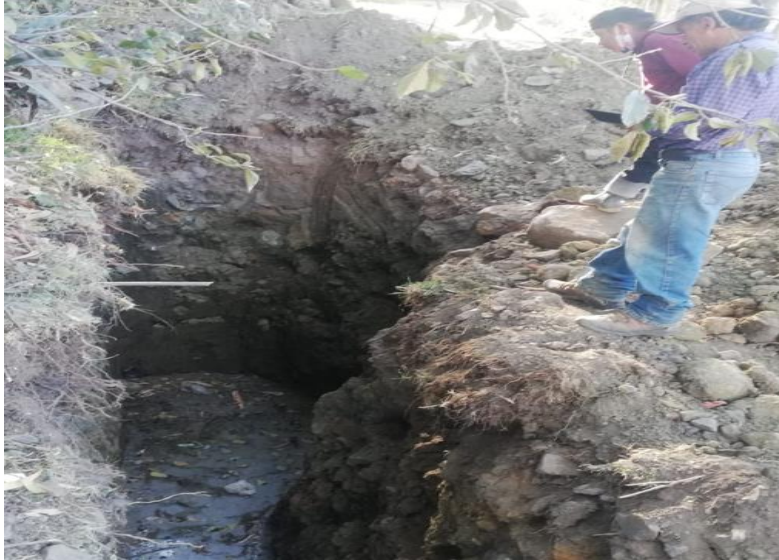
Nota. Excavación de zanja aprox. 3.00 m de profundidad hasta encontrar agua subterránea (2021).
