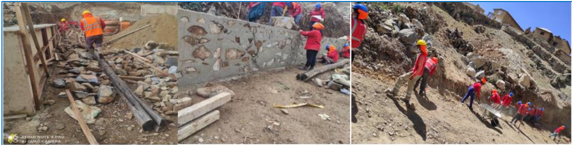
Foto 10. Vista fotográfica en actividades de desencofrado en la pantalla del muro con concreto ciclopeo 1:10 + 30% PG. 29/11/2021
