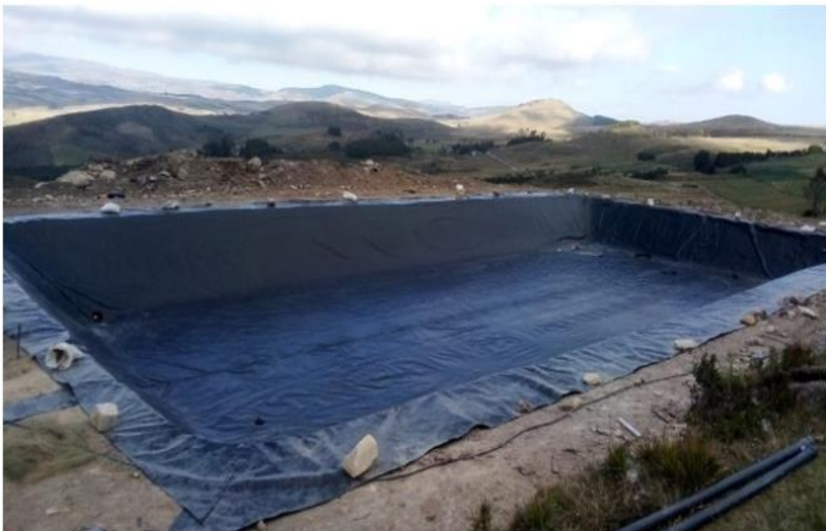
Figura 10 Reservorio Revestido con Geomembrana
